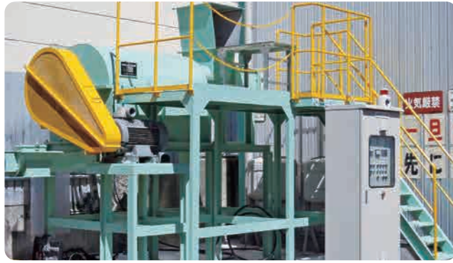
堆肥工場に設置(MMS-800)
