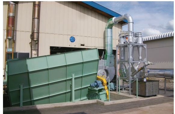
バイオマス蒸気ボイラー設備 (RPFの定量供給に利用)
